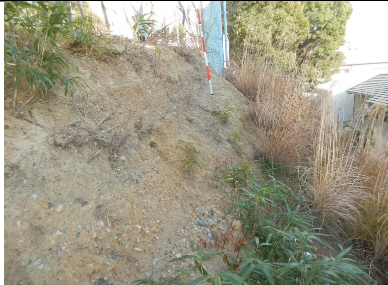
写真番号5 損傷写真(洗掘 L=15000×1500mm)
