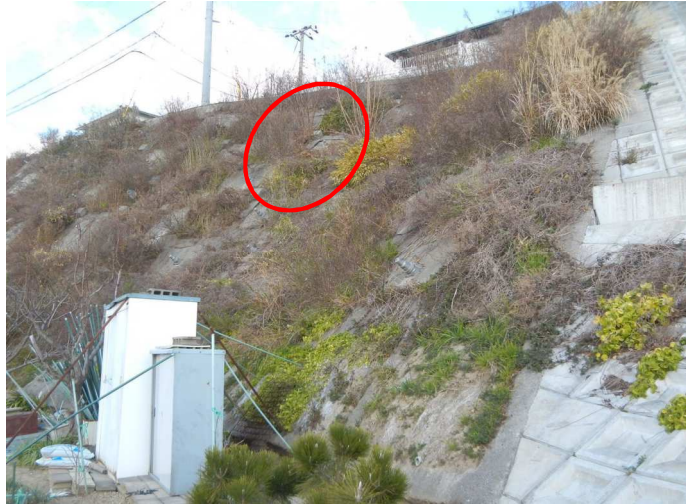
写真番号9 損傷写真(法枠ずれの恐れ)
