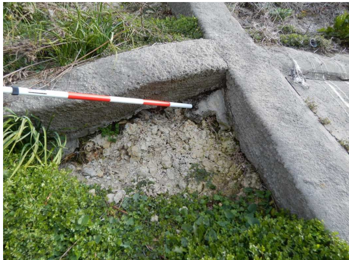
写真番号7 損傷写真(のり枠 枠内のモルタル剥離)
