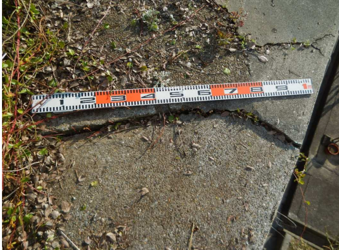
写真番号5 損傷写真(ひび割れ L=1000 W=30mm)
