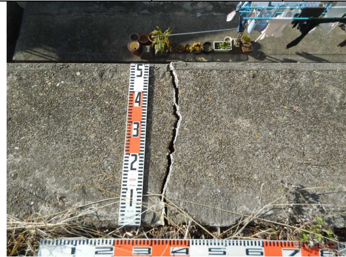
写真番号6 損傷写真(ひび割れ L=500 W=10mm)
