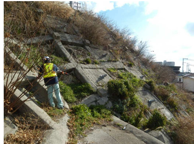
写真番号8 損傷写真(写真7の位置)
