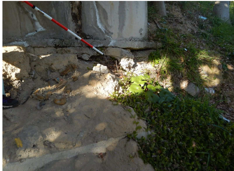
写真番号7 損傷写真(写真6の別角度)
