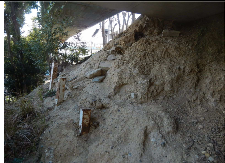
写真番号6 損傷写真(洗掘 L=10000×1500mm)
