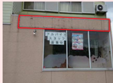
落下した後の壁面
