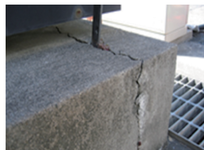
看板基礎のひび割れ
