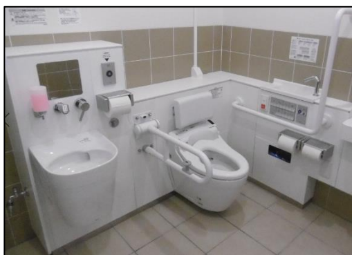
公園内の多目的トイレ(明石公園)
