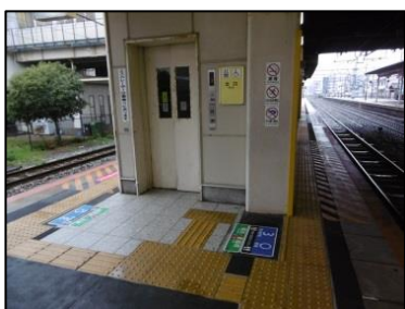
駅構内のエレベーター
