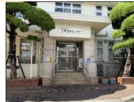
二見市民センター 施設内には、多目的トイレやエレ ベーターが設置されているが、バ リアフリー基準に適合していない。 歩道までの点字ブロックが設置さ れているが、同系色で規格外のも のである。
