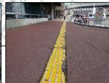
18. 明石市管理道路（馬場広場） 点字ブロックは設置されているが劣化している。
