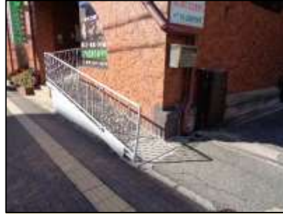
商業施設① 魚住124号線側の出入口は幅の狭く勾配の急な（0.84m、16.9%）スロープと階段のみ。駅側の出入口には段差（2cm）があり、点字ブロックは歩道との連続性がない。
