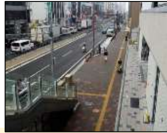
1. 国道2号 【特定事業】歩道巻き込み部の段差、勾配の改修・点字ブロックの設置、改修。
