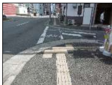
7. 西明石108号線 点字ブロックはあるが、劣化による凹凸がみられる。
