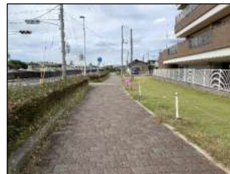
6. 二見35号線（ふれあいプラザ前歩道） 歩道幅員は広いが、点字ブロックが未設置である。
