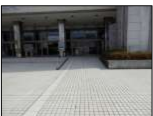
市民会館（アワーズホール） 出入口から歩道まで点字ブロックが設置されているが閉鎖戸へ誘導している。またタイルと同色のため識別しづらい。
