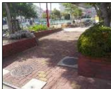
サンライフ明石 出入口から道路まで点字ブロックが未設置。
