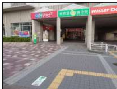
商業施設② 出入口から歩道までの点字ブロックが未設置。
