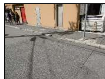
10. 西明石126号線 縁石の劣化による段差あり。
