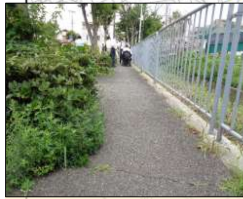
3. 林船上43号線（南側） 点字ブロックが未設置。植栽により幅員が狭い。
