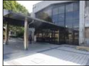
明石文化博物館 出入口から歩道まで点字ブロックが未設置。
