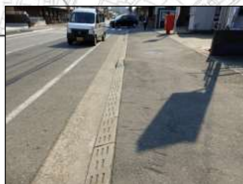
1. 林船上125号線（警察署前付近） 舗装の凹凸や横断勾配がきつい箇所がある。点字ブロックが未設置。
