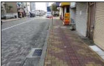
15. 明石中央40号線 点字ブロックが設置されているが、舗装と同系色でJIS規格外である。
