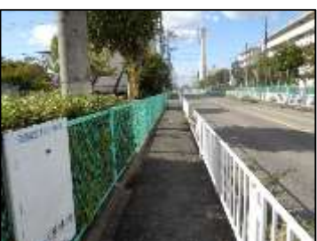
17. 藤江14号線（東側） 幅員が狭く、波打ち歩道が連続する。
