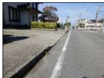
3. 二見22号線 点字ブロックが未設置である。幅員が狭く、横断勾配も急で乗り入れが多く移動が困難。
