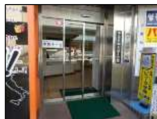
市民ホール 出入口から歩道まで点字ブロックが未設置。
