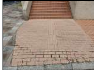
勤労福祉会館 出入口から歩道まで点字ブロックが設置済だが規格外。
