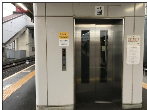
駅構内のエレベーター
