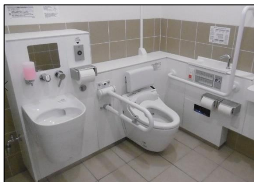
公園内の多目的トイレ(明石公園)
