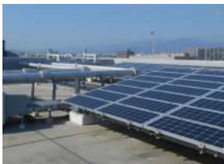
【太陽光発電の事例（茅ヶ崎市役所）】
