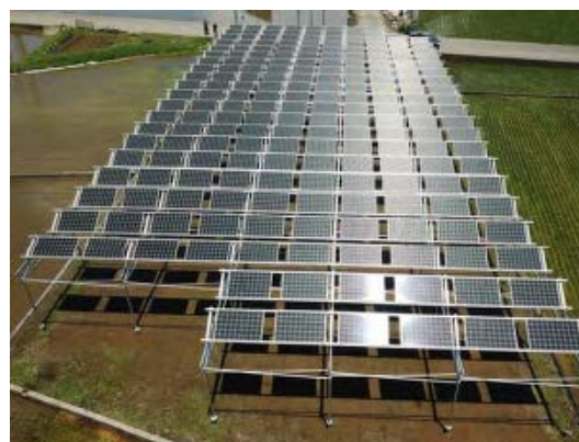
発電設備の全景
