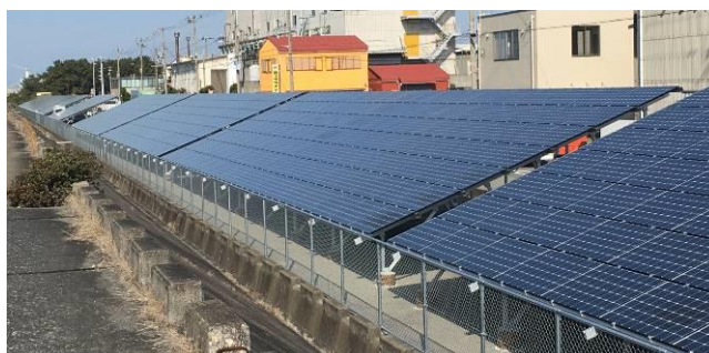
南二見人工島の太陽光発電設備
