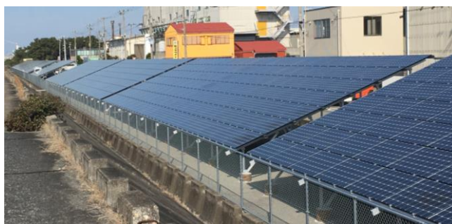
南二見人工島の太陽光発電設備
