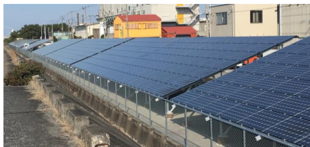
南二見人工島の太陽光発電設備
