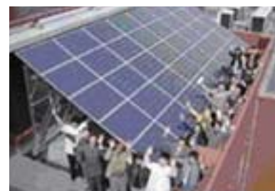
環境ネットワークくまもとの市民太陽光発電所
