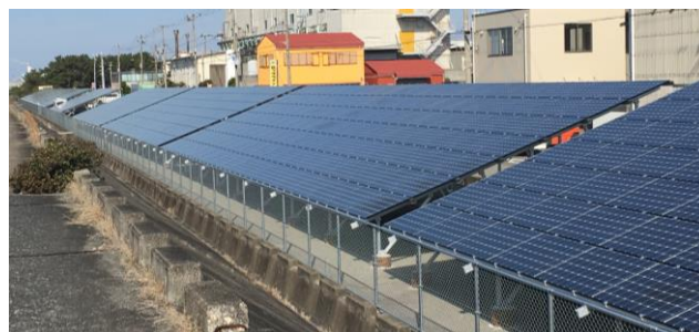
南二見人工島の太陽光発電設備
