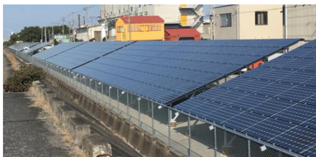
南二見人工島の太陽光発電設備
