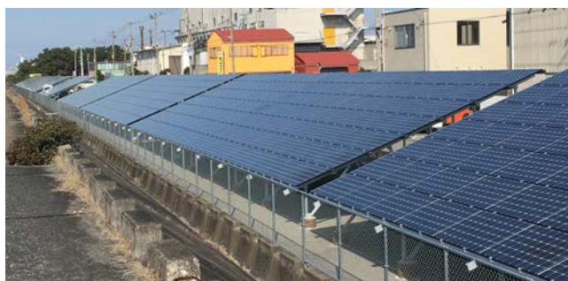
南二見人工島の太陽光発電設備
