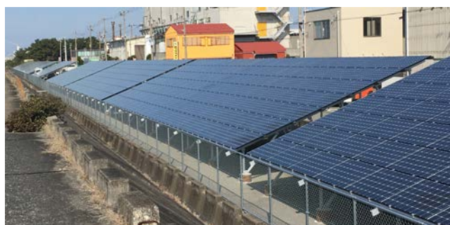
南二見人工島の太陽光発電設備
