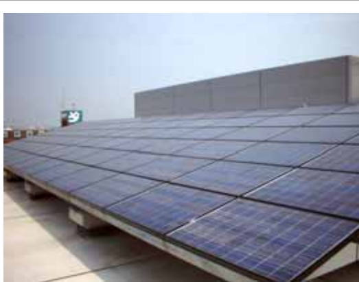
図 4-5 新消防庁舎に設置された太陽光発電パネル
