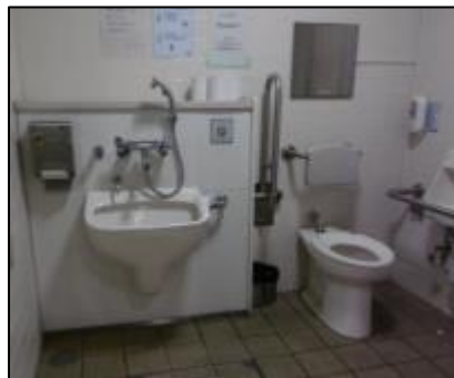
駅構内の多目的トイレ
