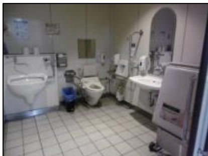
駅構内トイレに大型ベッドを設置(JR 西明石駅)
