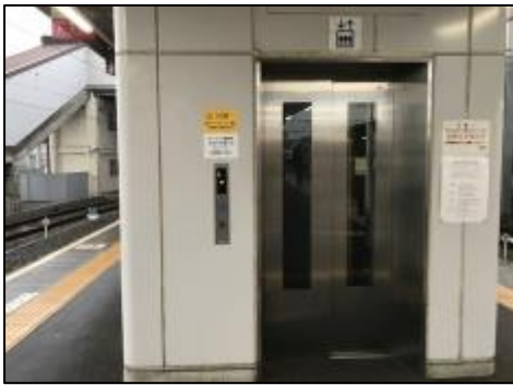
駅構内のエレベーター
