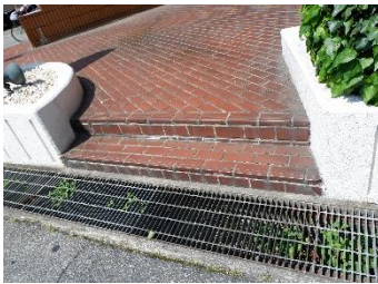
出入口の付近の段差
