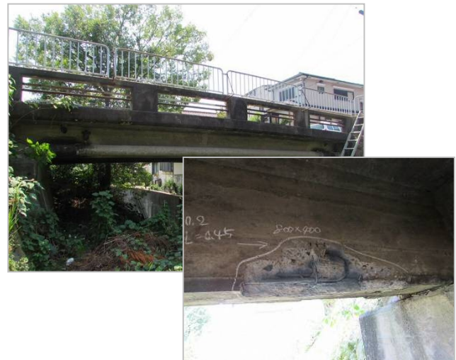
コンクリート床版の剥離（61年経過の橋梁）
