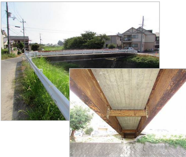
鋼材の腐食（38年経過の橋梁）
