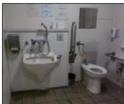
駅構内の多目的トイレ
