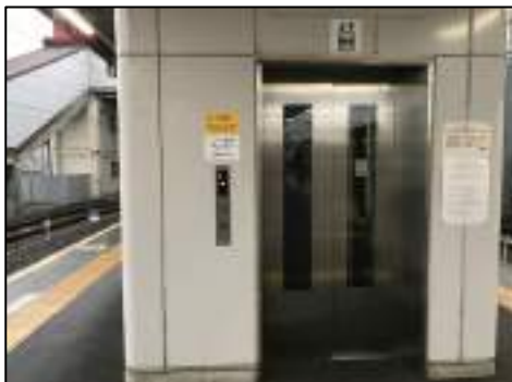
駅構内のエレベーター
