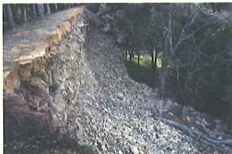
震災で崩れた二ノ丸の北辺石垣
