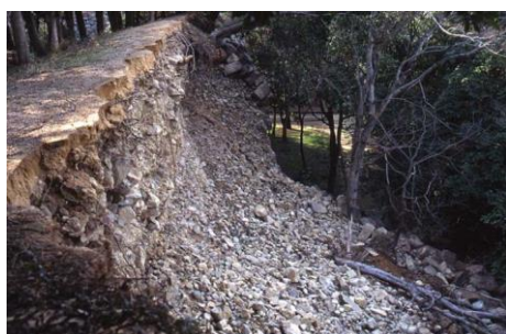
震災で崩れた二ノ丸の北辺石垣 (兵庫県立歴史博物館 HP)
