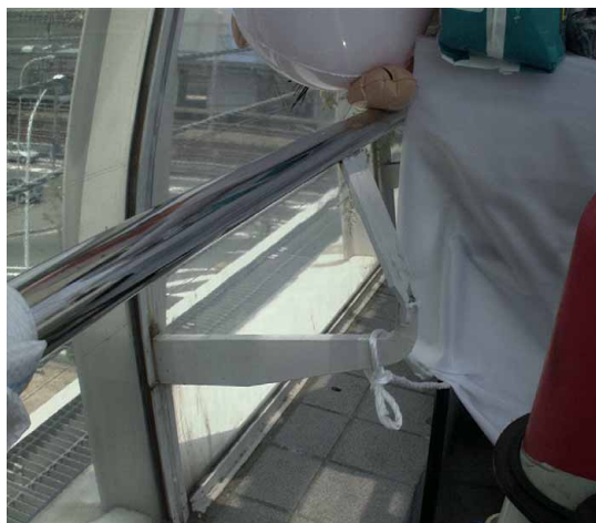
写真 2-4-1 変形した支持板（西側）
