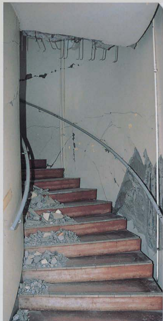
天井や壁が崩れ、鉄筋がむき出しになったらせん階段
