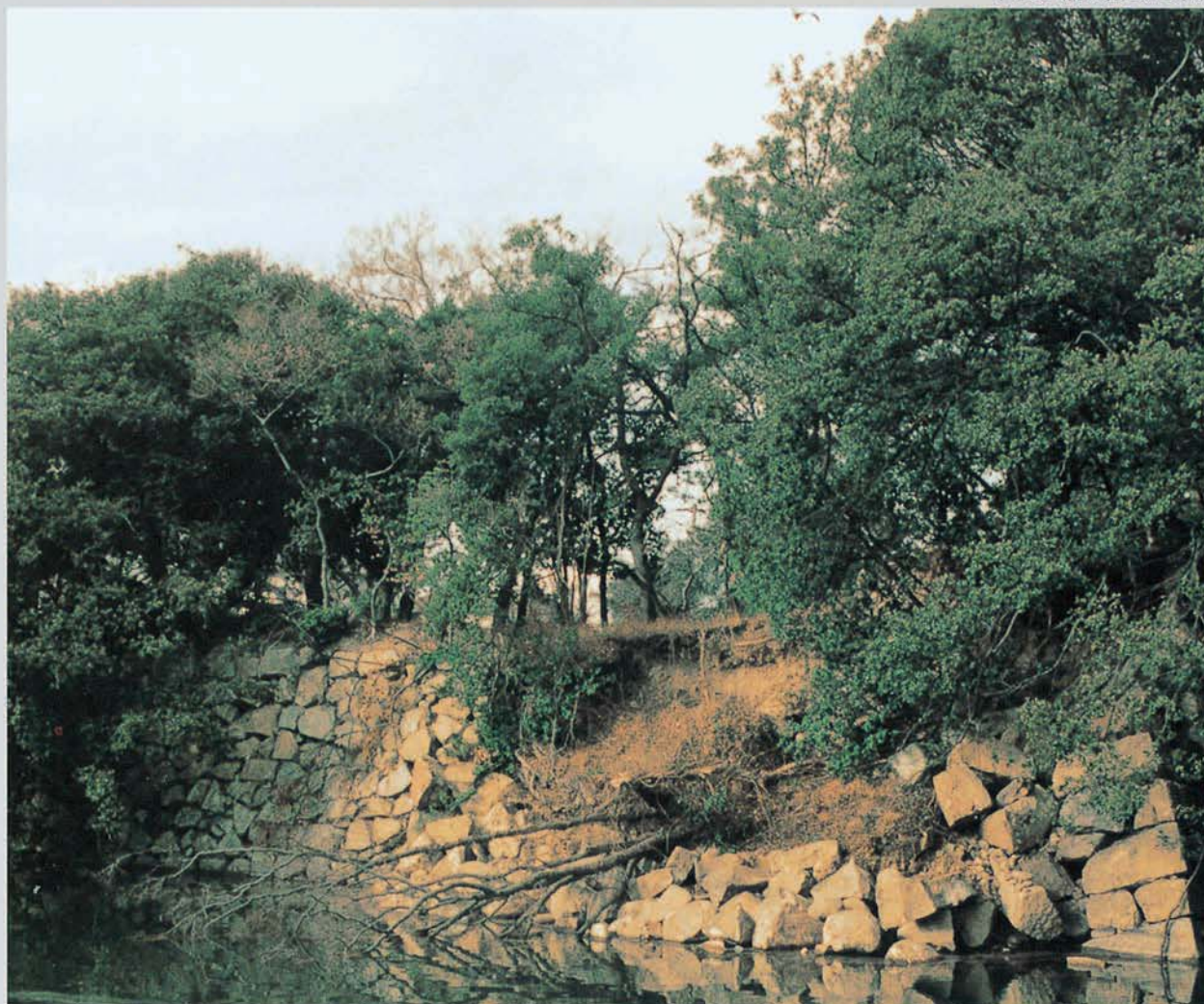
石垣が崩れ落ちた外堀
